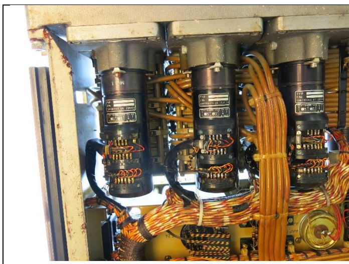
Drei Motoren des Feuerleitgerätes 63/69 zur Nachführung der Geschwindigkeitswellen: Geschwindigkeit des Flugzeuges in Ost/West, Nord/Süd, und vertikal. Auf den Drehwellen (seitlich dahinter) sitzen die Kondensatoren, mit denen gerechnet wird. Orange Koax-Kabel: von Kondensatoren zu den Verstärkern. – Löt-Anschlüsse Motor (oberste Reihe) und Generator (mittlere Reihe) zusammen 9 ohne Erdung. Unterste Reihe: Temperatur-Kompensation. Motor-Generatoren: 12 cm lang. Im Unterschied zum Mirage-Rechner werden die Generator-Spannungen (hier: Beschleunigungen des Zieles) auch zum Rechnen benutzt, zusätzlich zur blossen Regelung der Grösse.
